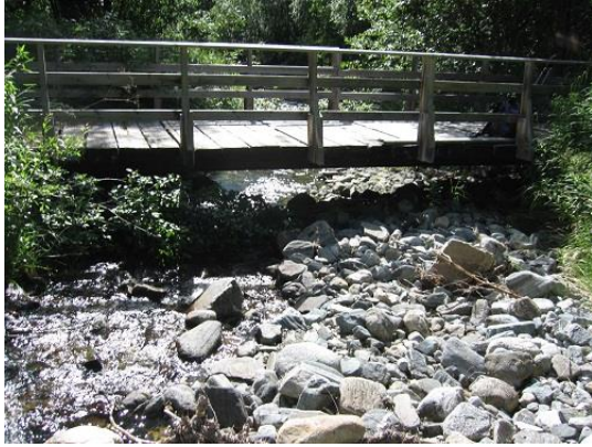
Figur 33: Bilder fra trebru som krysser Fotfola mellom jernbanen og Lesjaskogsvannet. Viser avlagring av store mengder løsmasser, slik at lysåpninga under brua er blitt svært liten.
