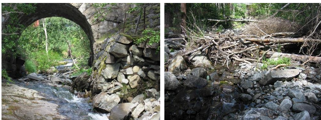
Figur 32: Bilder fra Fotfola ved jernbanen. Til venstre er nærbilde av skadene i erosjonssikringa nedstrøms Jernbaneverkets kulvert (store deler er vasket bort). Til høyre sees avlagring av store mengder løsmasser og trær rett nedstrøms.
