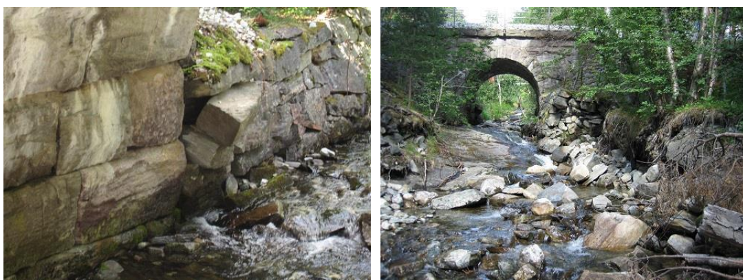
Figur 31: Bilder fra Fotfola ved jernbanen tatt nedstrøms fra. Til venstre vises nærbilde av innløp til Jernbaneverkets kulvert med skader i erosjonssikringa (er i ferd med å gli ut). Til høyre sees mer omfattende skader rett nedstrøms utløpet til høyre. Viser også at det så langt nedstrøms er omfattende massetransport med store steiner.
