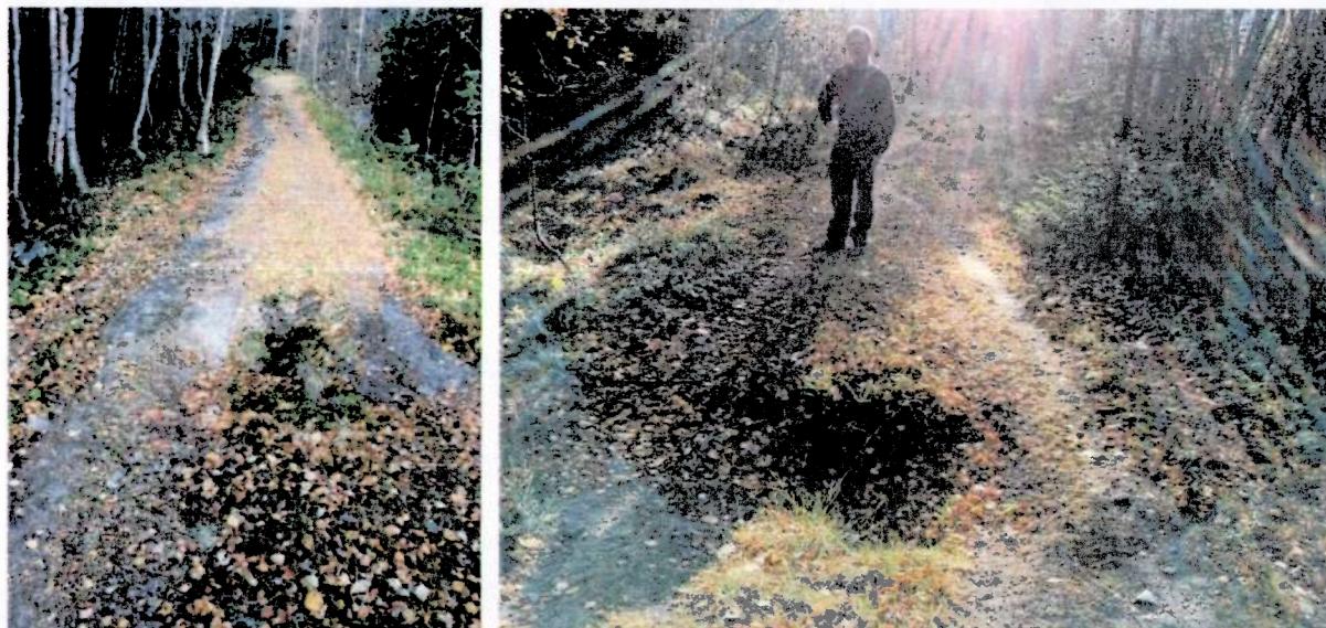
Figur 13: Bilder fra der en skogsbilvei krysset bekketraseen, ca 775 moh. Tydelige spor på overflaten etter sammenrast stikkrenne.
