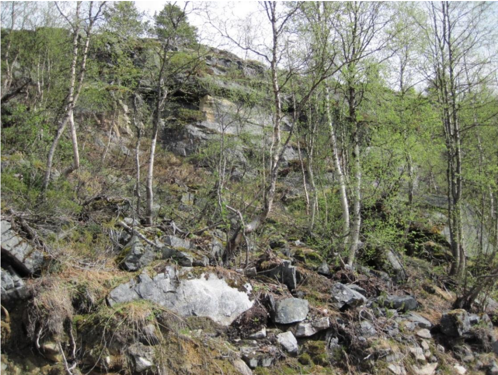
Bilde 5: Skredmasser fra tidligere steinsprang. Uregelmessig form av trestammer tyder på at massene ligger ustabil.
