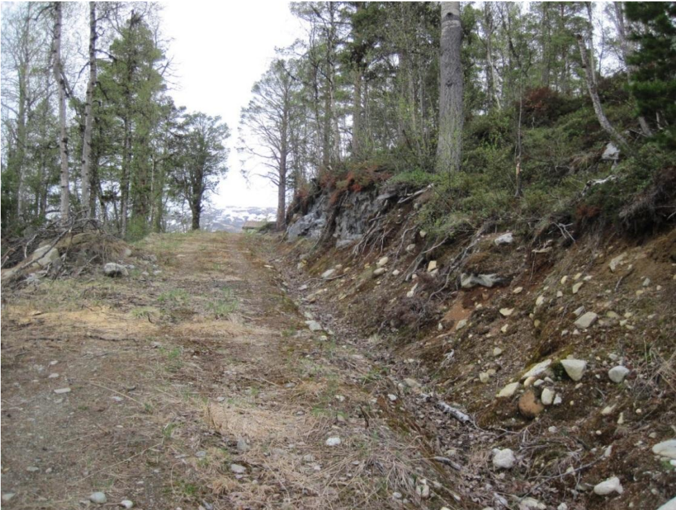
Bilde 3: Morenematerial. Uten erosjonssikring kan det oppstå grunnbrudd i bratte veiskjæringer.
